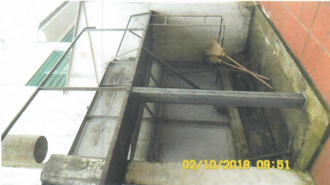
AINDA NÃO REALIZADO REFORMA PARTE EXTERNA
