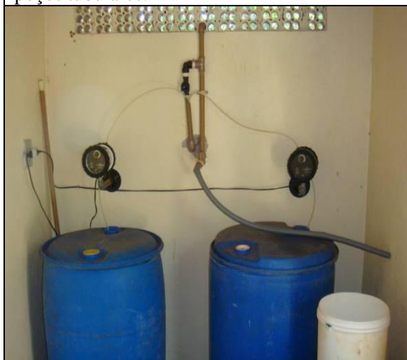
Foto 09: Sistema de aplicação de Cloro e Flúor para o poço GMI-19.
