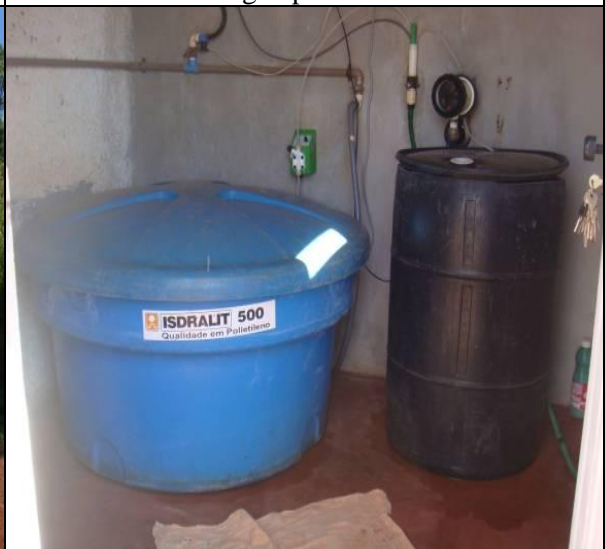
Foto 04: Sistema de aplicação de Cloro e Flúor para o poço GMI-15.
