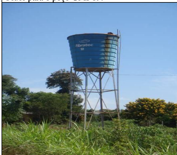
Foto 11: Reservatório Elevado com capacidade de 50m 3 para abastecimento do Bairro Santa Fé.
