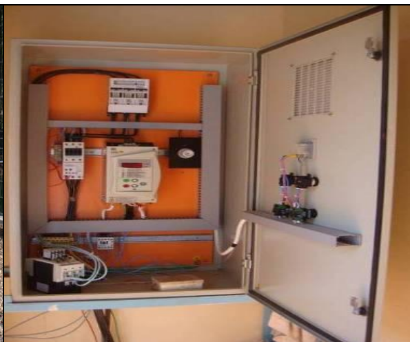
Foto 08: Novo sistema soft-starter para operação do conjunto motobomba – poço GMI-19.
