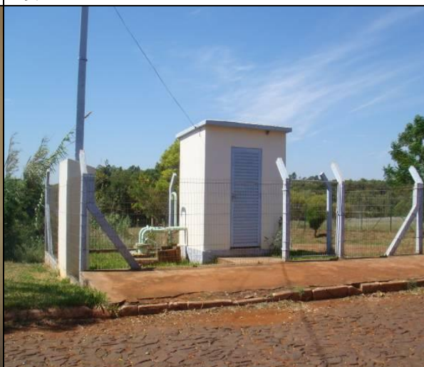
Foto 10: Booster "in line" para abastecimento do Bairro Santa Fé.
