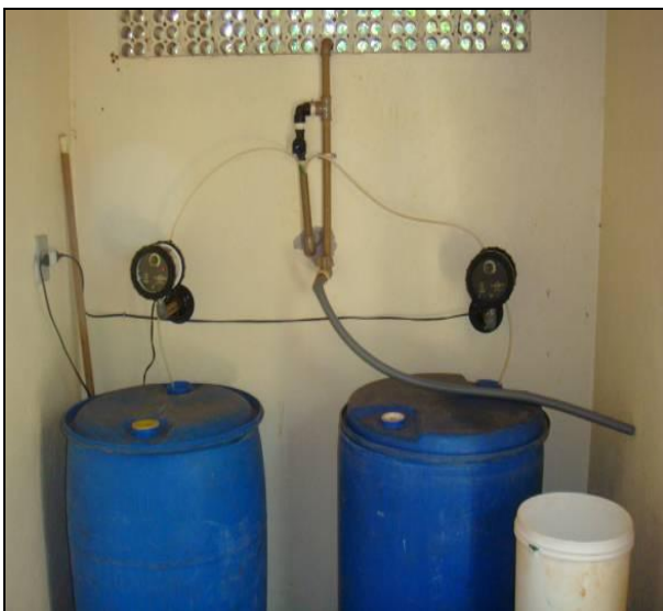
FOTO 03 – Estação de Tratamento de Água
