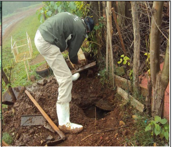
FOTO 02 – Instalações operacionais de coleta
