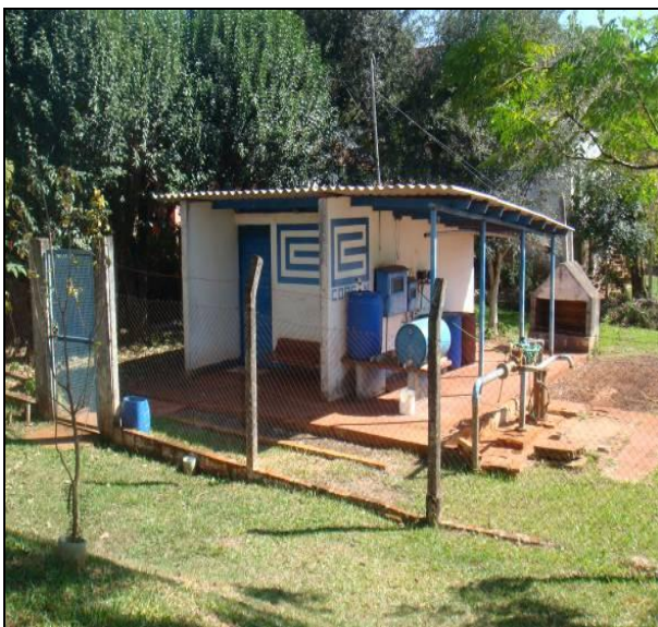
FOTO 01 – Captação da Água
