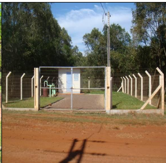
FOTO 02 – Estação Elevatória de Água Bruta
