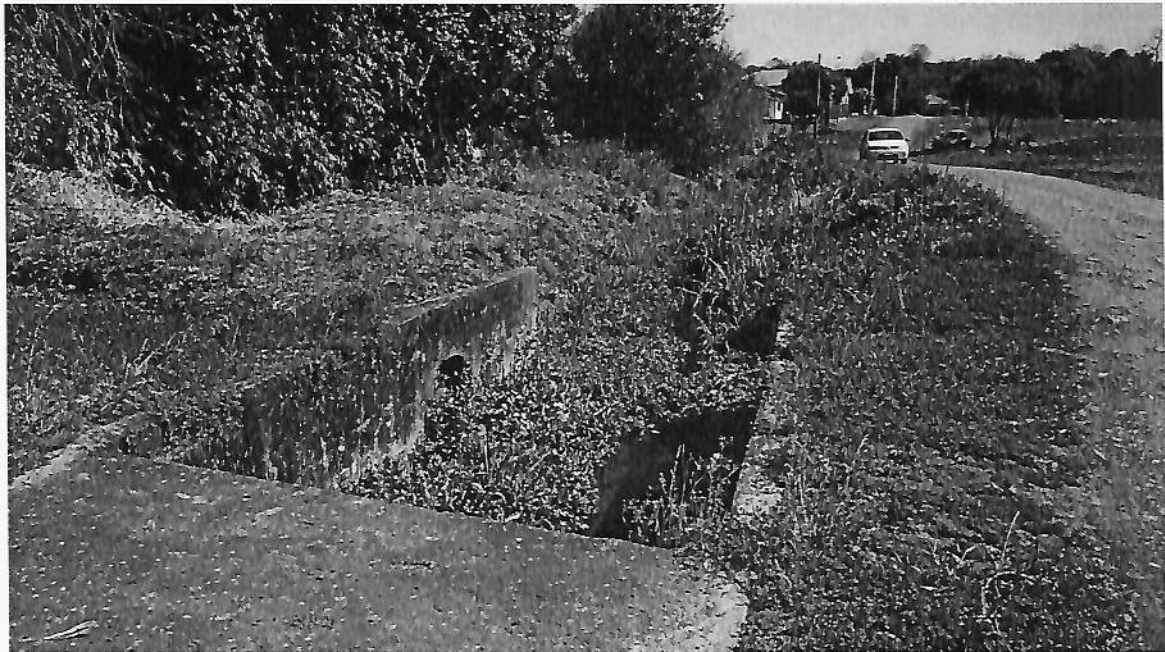
Foto 06 – Água proveniente das sangas e galeria (Rua São Borja)
