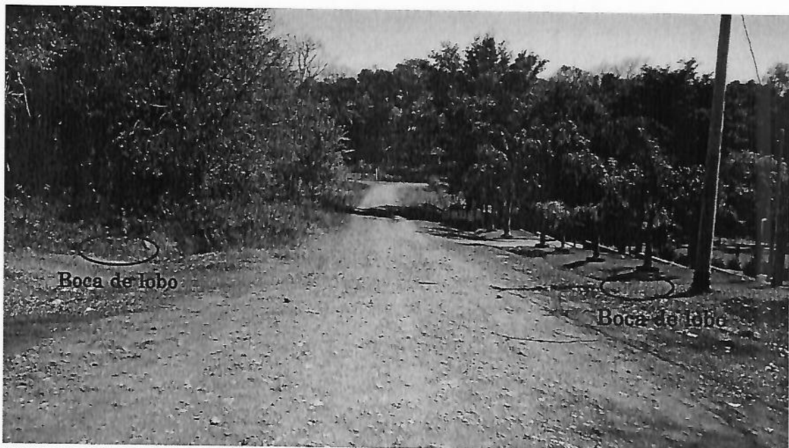
Foto 03 – Bocas de lobo da Rua A
