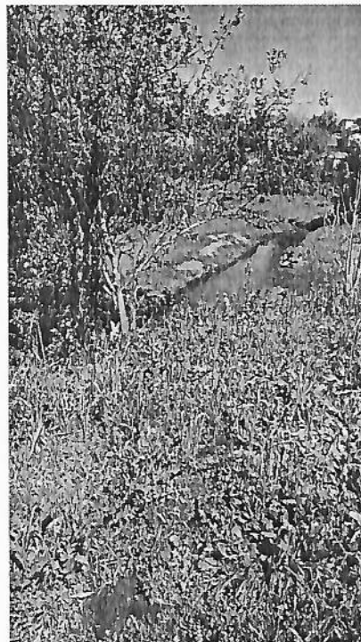
Foto 05 – Sanga 02 (Rua São Borja)
