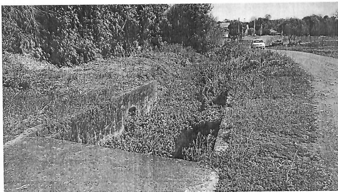
Foto 06 – Água proveniente das sangas e galeria (Rua São Borja)
